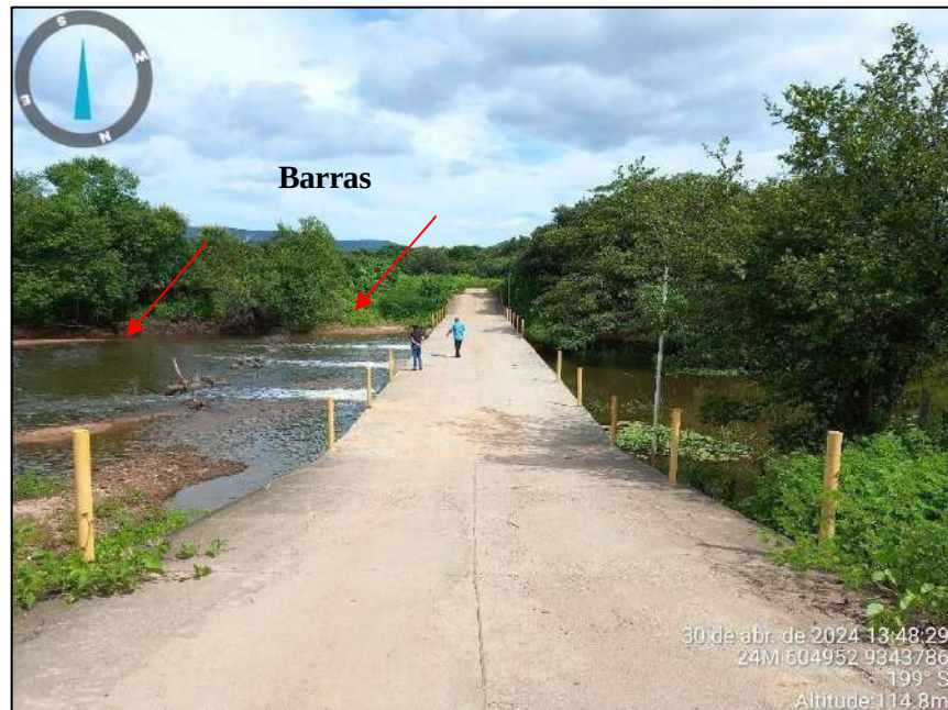
Figura 34- Formação de barras próxima as manilhas no trecho 10-11
