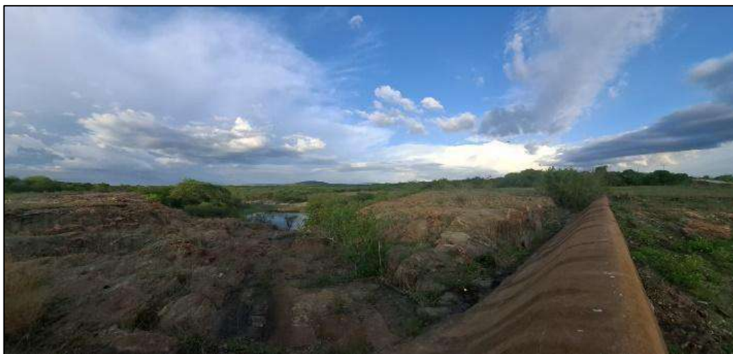
Figura 27- Barragem Pedro Diógenes Fernandes - Pau dos Ferros/RN, evidenciando o seu vertedouro
